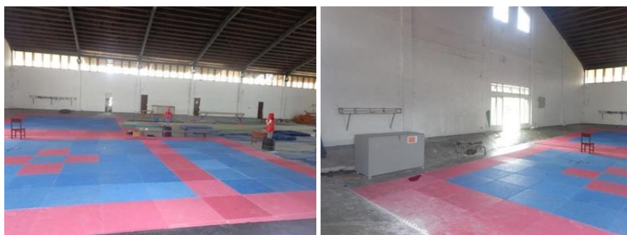
Gambar 6. Gedung Serbaguna yang sudah rusak digunakan sebagai tempat latihan olahraga Senam, Taekwondo, dan Karate
