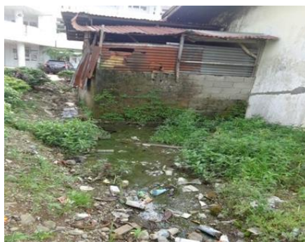
Gambar 4. Sanitasi atau drainase pada gedung asrama putri, yang tergenang dan banyak tumpukan sampah
